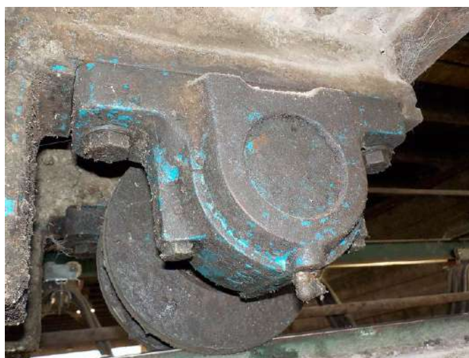
Struttura Carrello ESAME VISIVO
